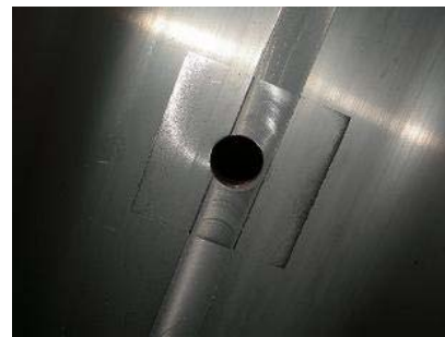
(d) 試験箇所 II のアルミニウム床版下面
